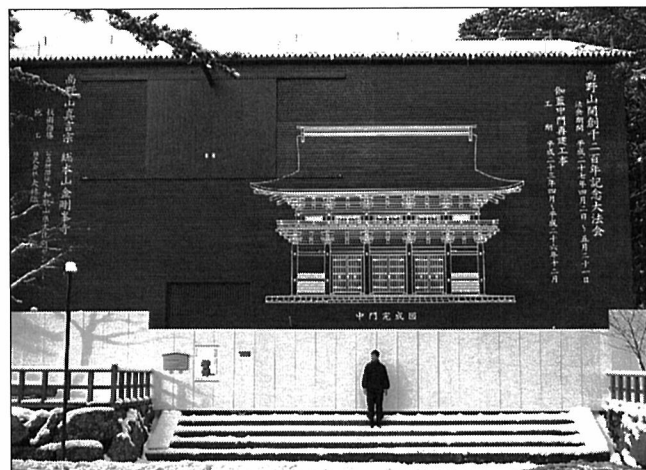
霊宝館側から見た様子。建物全体が覆われているため天気に関係なく工事が進められている。
